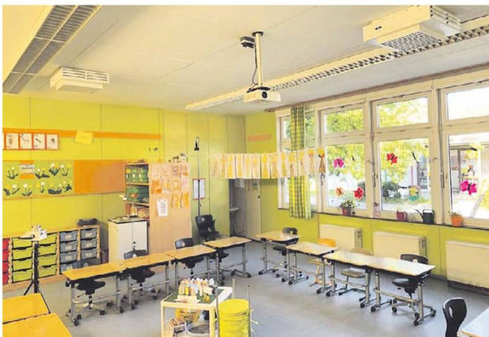
Gute Luft im Klassenzimmer: An der Decke dieser Grundschule hängen zwei der Plasmaluftreingier. In Tests des Fraunhofer-Instituts für Bauphysik sank die Viruslast der Luft um 70% ab. Foto: Plasmacomplete
